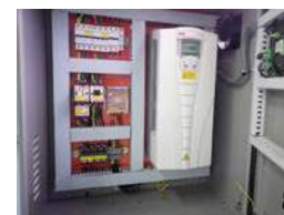
明珠廠A棟抽風機變頻節能改造
