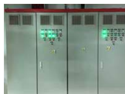
PH5中央空調水泵變頻節能
