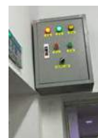
廠房洗手間排風機安裝定時開關
